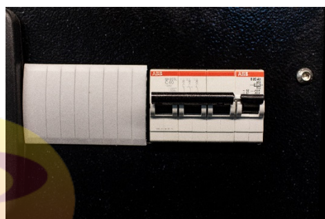
Электрическая часть ДГУ производства ABB
